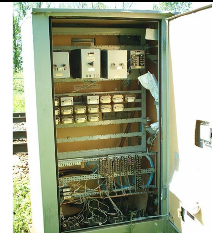
Напольное оборудование АЛС-ЕН
